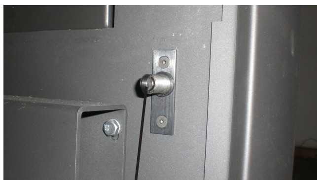
Door contact switch
