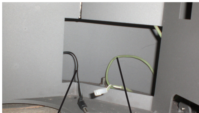
Câble alimentation électrique Câble de sonde
